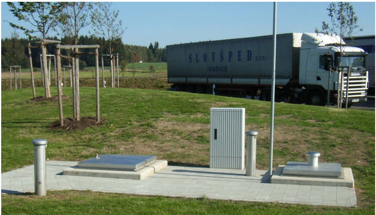
PWC-Anlage in der Oberpfalz, pneumatisches Abwasserpumpwerk
