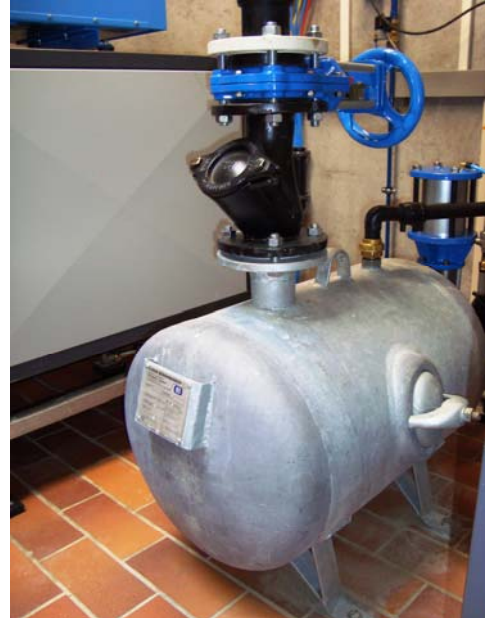
Arbeitsbehälter einer rein unterirdischen pneumatischen Abwasser-Förderanlage, mit Armaturen; Kompressoren im Hintergrund
