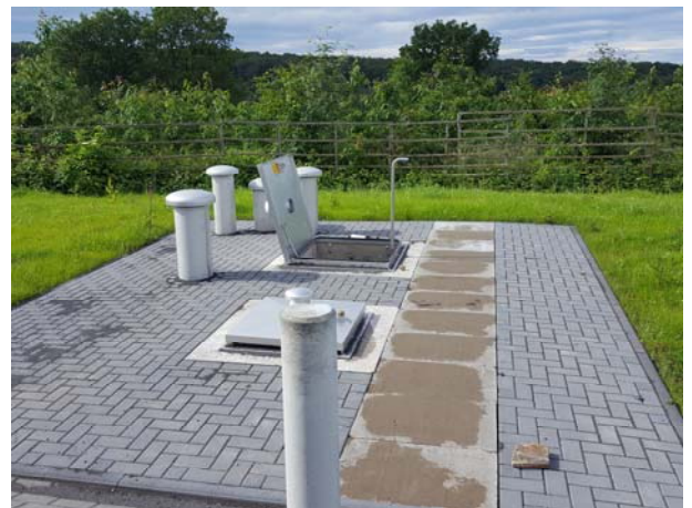
Lüftungsrohre, Einstieg und Schalldämpferwanne eines rein unterirdischen pneumatischen Abwasserpumpwerks
