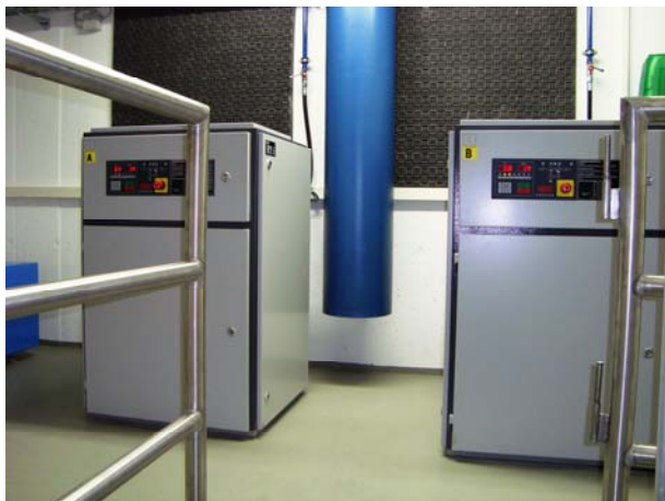
Kompressoren einer pneumatischen Abwasser-Förderanlage in Oberbayern
