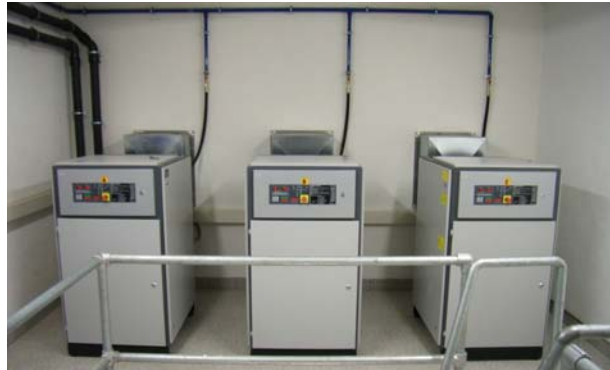
Schraubenkompressoren einer Dreifachanlage
