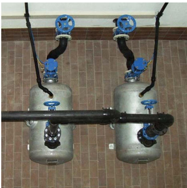
Arbeitsbehälter mit Armaturen und Rohrleitungen
